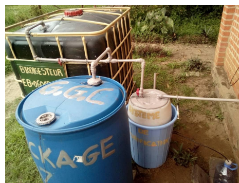
Fig. 1. The EB.06019.LHT-MWINDA biodigester
